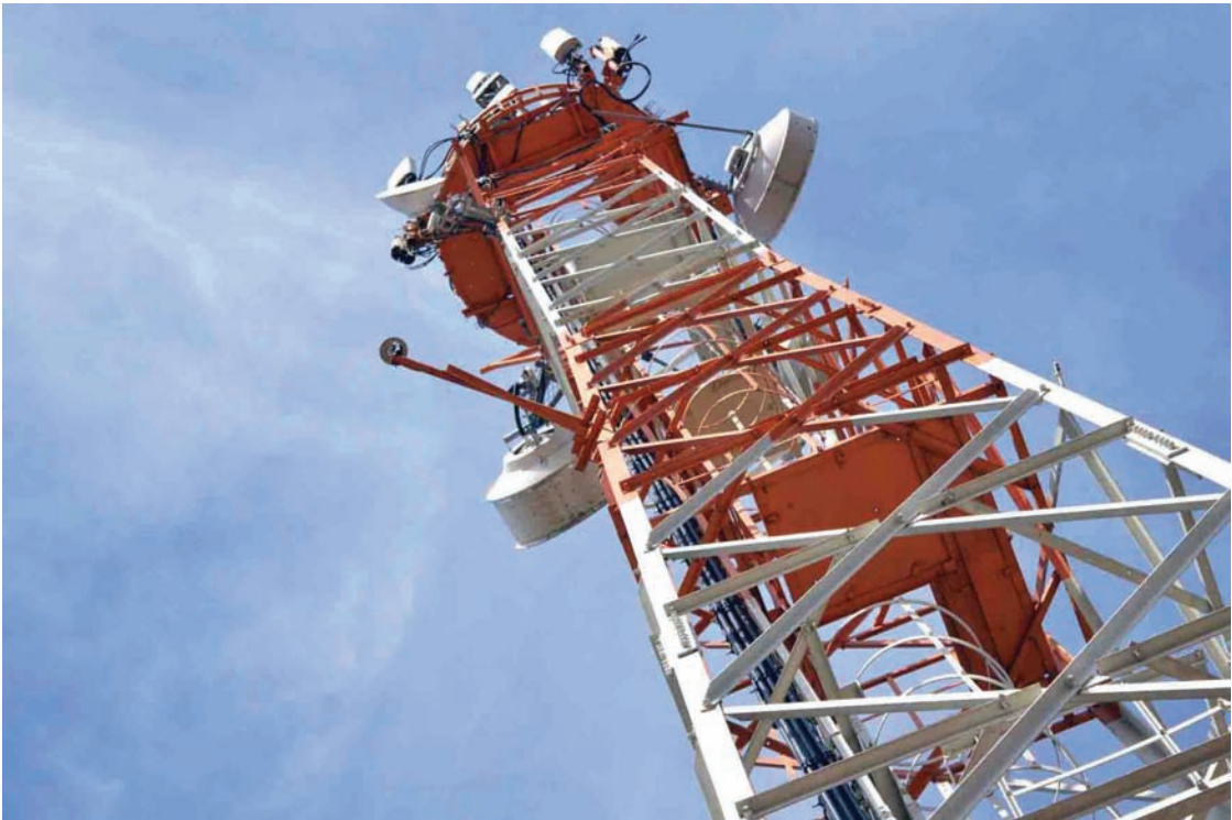
Foto ilustrativa de uma estação transmissora de serviços de telecomunicação. Crédito: Juliana França/Flickr)
