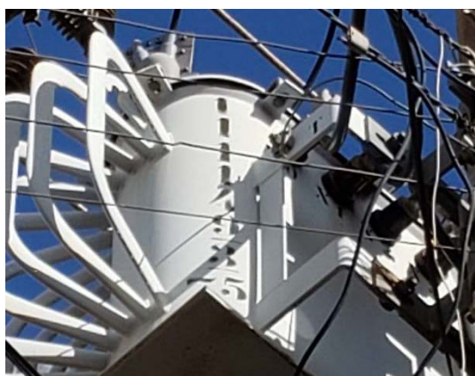
FIGURA 1-POSTE DE RECEBIMENTO (SEM IDENTIFICAÇÃO)
