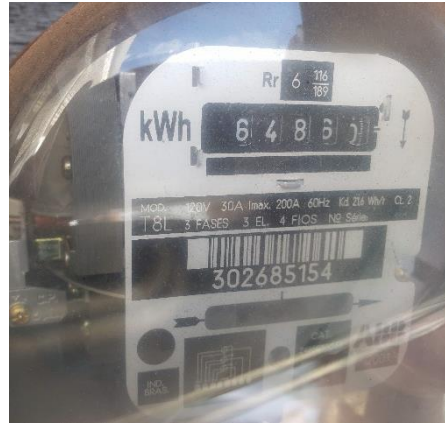
FIGURA 2 – MEDIDOR DE ENERGIA (NR 302685154)
