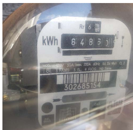
FIGURA 2-MEDIDOR DE ENERGIA (NR 302685154)
